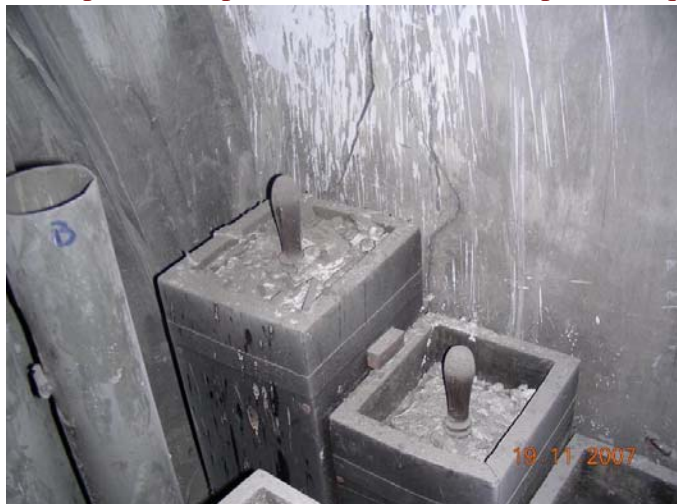
Dépôts sur tuyaux de bois de 16'
