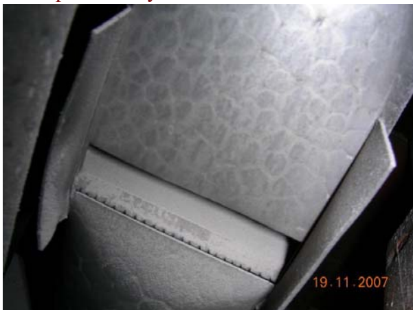
Dépôt de poussières sur les biseaux (bouches des tuyaux)
